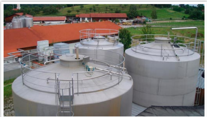
Abb. 2: SBR-Reaktoren zur Klärung von Molkereiabwasser
