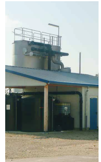
Abb 5: Nachgeschaltete, kontinuierlich gespülte Sandfilterstufe (System „Nordic-Water“)
