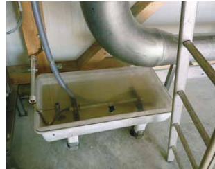
Abb 4a: Einbausituation S:CAN-Sonde zur Ablaufüberwachung
