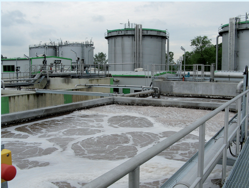
ERWEITERTE KLÄRANLAGE ZEITZ: zweistufige Belebungsanlage
