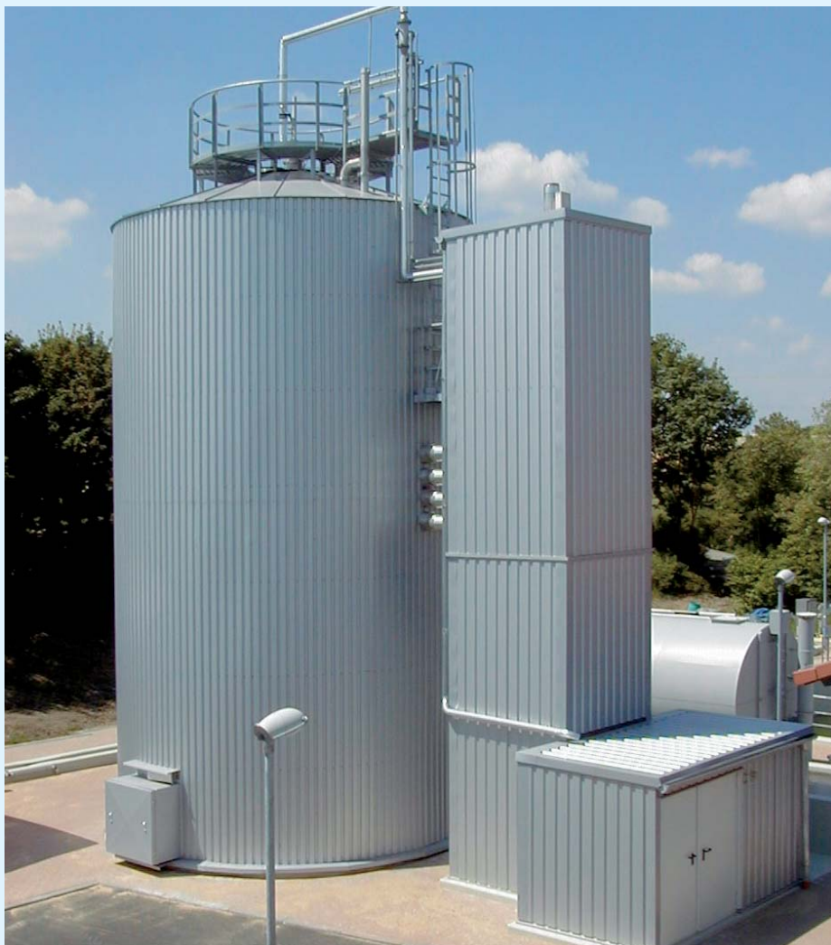
Faulbehälter mit Gasspeicher
