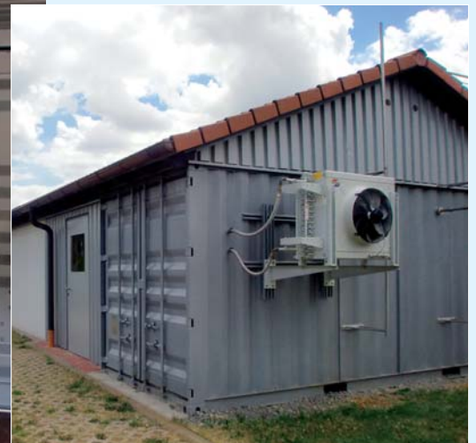
AUSSENANSICHT: BHKW-Container mit Notkühler
