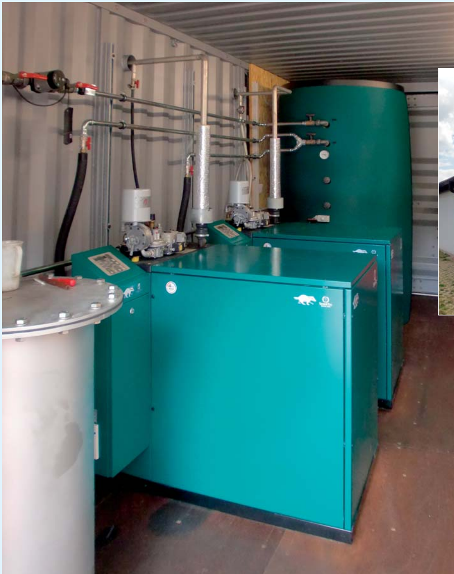
BHKW-MODULE im Container Bild 4
